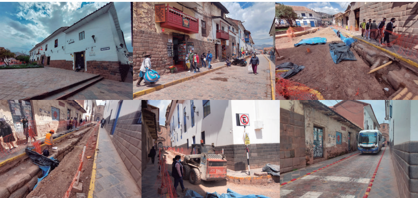
Figura 9. Calle Zetas. Hallazgos de muros incas bajo la superficie de rodamiento de la vía, posterior enterramiento y ulterior habilitación para la circulación vehicular.
